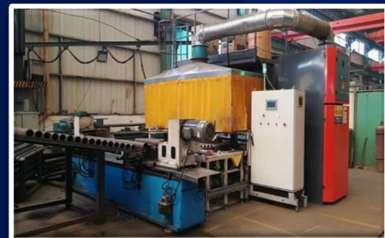
Роботизированное рабочее место для сварки наклонных стержней
